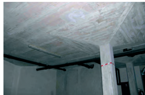
Consequência: grandes perdas térmicas e espaços termicamente desconfortáveis. Em espaços aquecidos acima de zonas frias são visíveis condensações e bolores.
