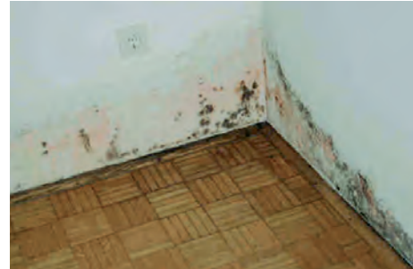
Humidade e bolores, prejudiciais à saúde, visíveis na parede.
