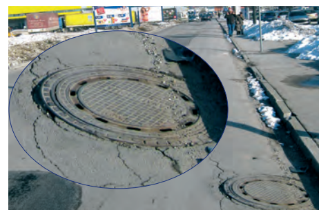
Congelamento de terreno pantanoso, nomeadamente na presença elevada de água, causa danos em estradas e sistemas de drenagem.
