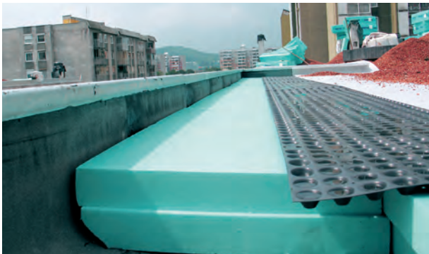
A execução do isolamento térmico das coberturas verdes está descrito na brochura 0111 – Coberturas planas invertidas (brevemente).
